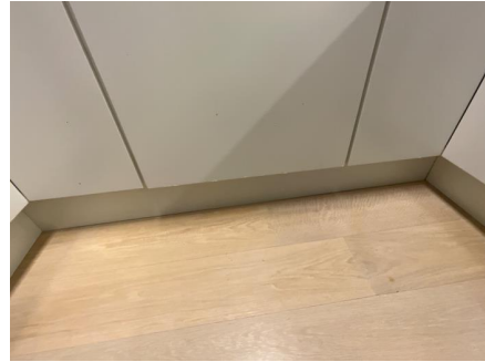
Svelleskade på skuffeplate under oppvaskkum
