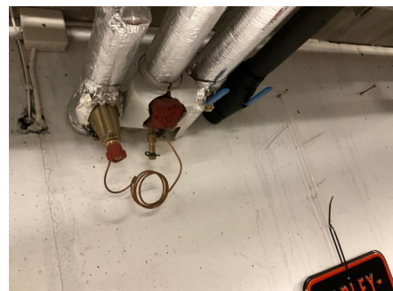
Hovedstoppekran for kaldt og varmt vann er plassert på utsiden av leilighetsveggen i garasjen
