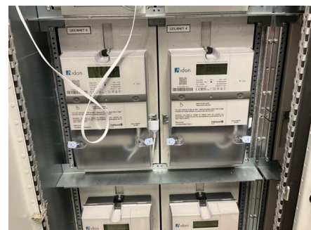
Strømmåler og hovedsikring til leiligheten er plassert i sameiets felles tekniske rom
