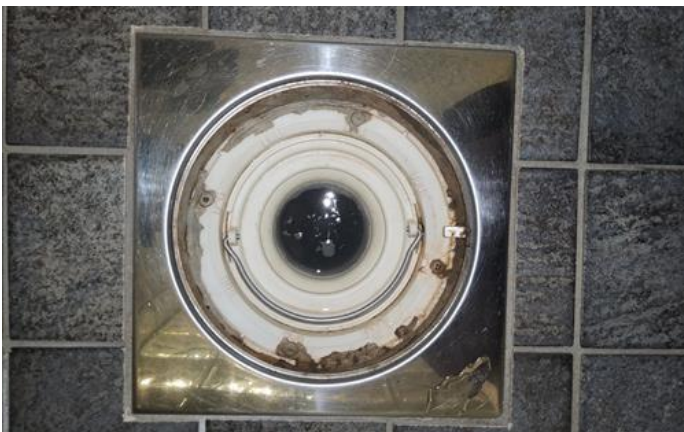
Avløpsrør (ink. sluk) - [Sluk på bad 1.etasje]
