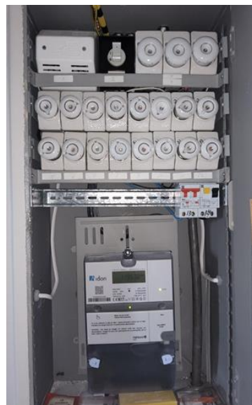
Elektrisk anlegg - [Sikringskap]
