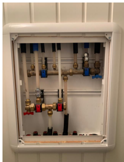
Rørfordelingskap plassert i bod ved siden av bad/vaskerom i kjelleren.
