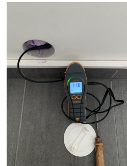
Hulltaking med fuktmåling rom under terreng.
