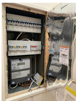
Sikringskap plassert i gang/trappoppgang i 1. etg..
