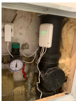
Hovedsikringskap, vannmåler og vannsikring med aquastopp montert i vegg på bad/vaskerom.
