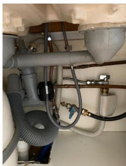
Avløpsrør i underskap vask på kjøkkenet.
