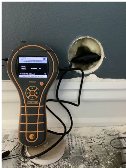
Fuktmåling i vegg mot bad.
