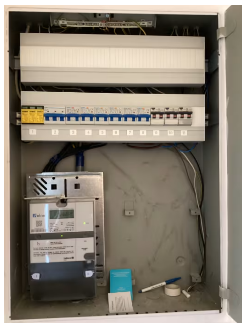
Sikringskap i entre.
