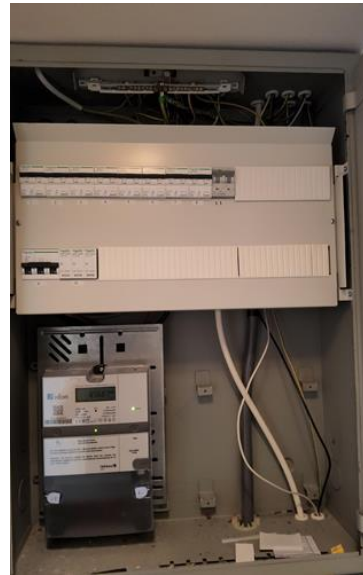
Elektrisk anlegg - [Sikringsskap]
