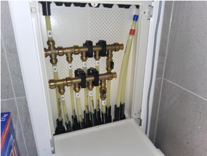
Vannrør - [Fordelerskap bad ]
