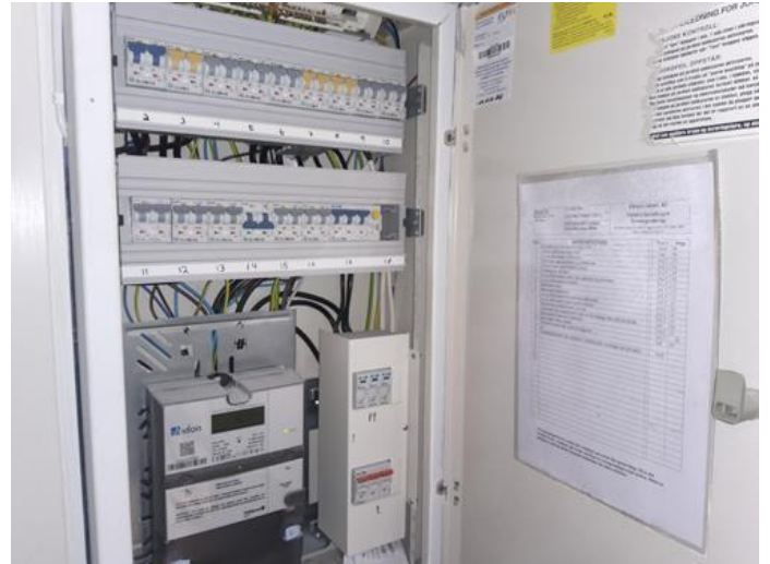
Beskrivelse - [Sikringskap og kursfortegnelse ]
