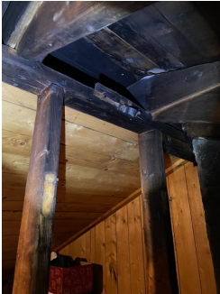
Sot etter brann pga lynnedslag opplyst av tidligere eier
