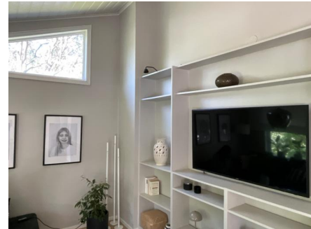
Pipen som ikke er i bruk
