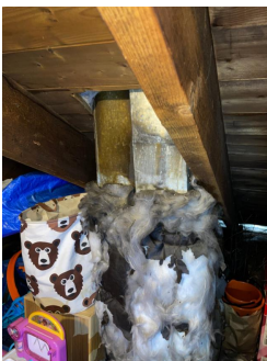
Ventilasjonskanaler trenger ny isolasjon
