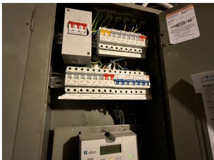
Sikringskap til boligen
