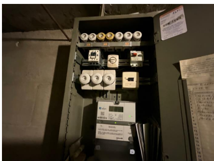
Inntak sikring er gamle skrusikringer
