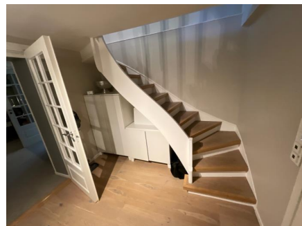
Trappen mangler rekkverk
