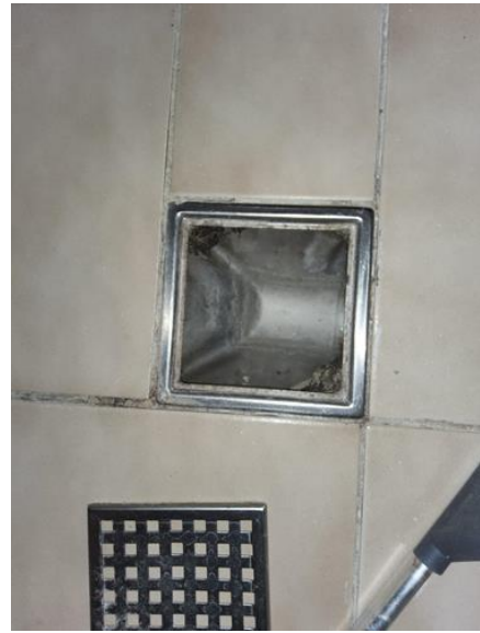
Membran, tettesjikt og overgang til sluk. - [Sluk dusjsone]
