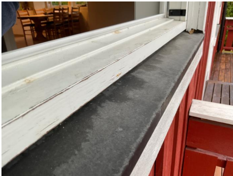
Avflassing av maling på utvendig karm.
