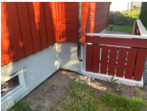
Utkast ved grunnmur.
