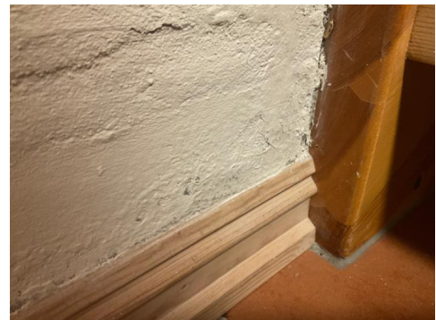
Krakelering av maling.
