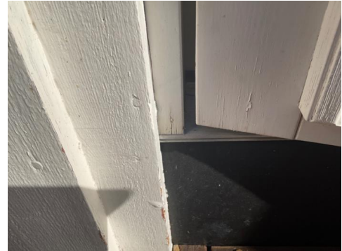
Oppsprekking og avflassing av maling.
