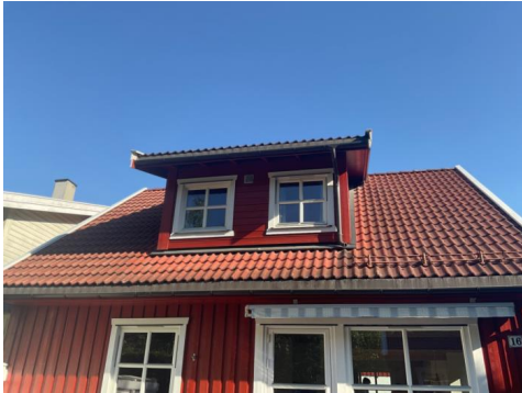
Mangler snøfangere på deler av taket.
