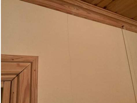
Riss i plateskjøt i entre.
