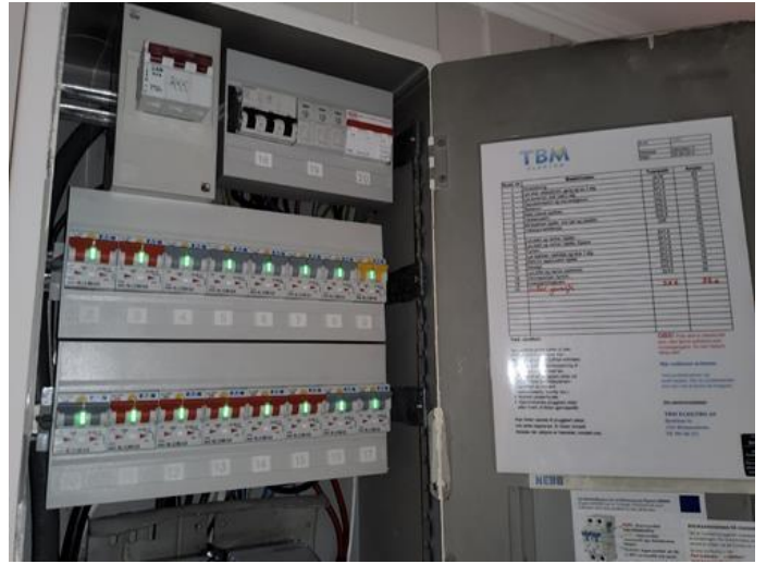
Beskrivelse - [Sikringskap med kursfortegnelse.]
