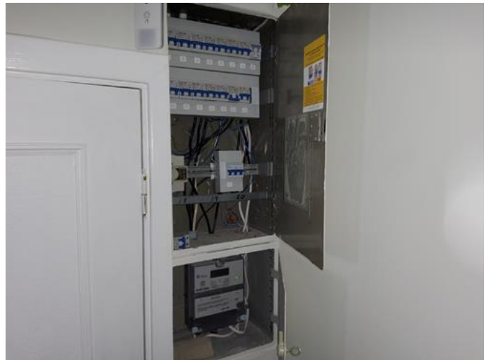
Elektrisk anlegg - [Sikringsskap. ]
