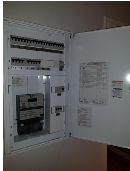
Elektrisk anlegg - [Sikringskap ]
