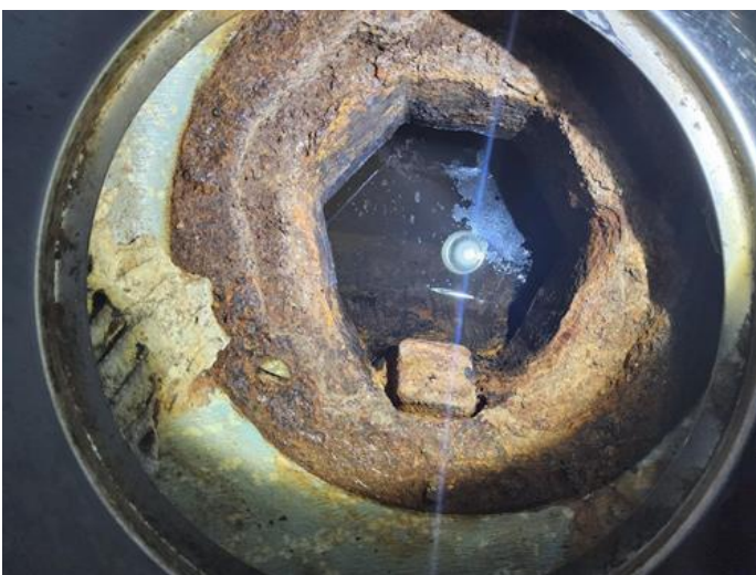
Kommentar - [sluk bad 1.etasje ]
