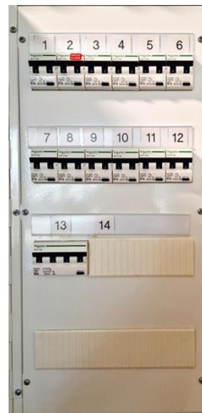
Elektrisk anlegg - [Sikringskap soverom 2. etasje]
