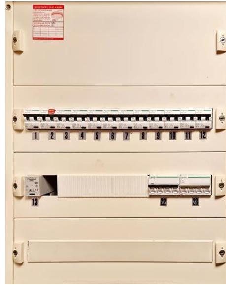
Elektrisk anlegg - [Sikringskap vaskerom]
