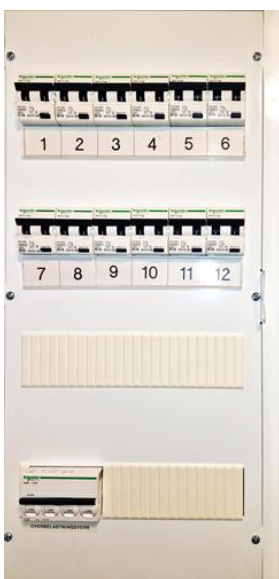
Elektrisk anlegg - [Sikringskap utleie]
