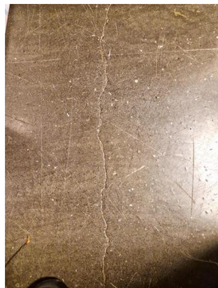
Våtrom - [Riss i betonggulv]
