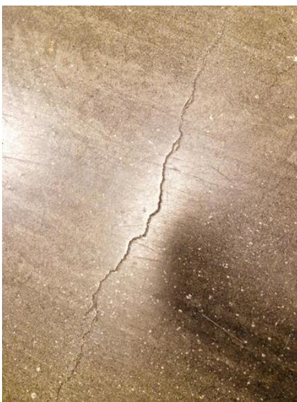
Våtrom - [Riss i betonggulv 2]
