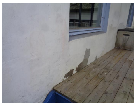
Malingsavskalling på grunnmur.
