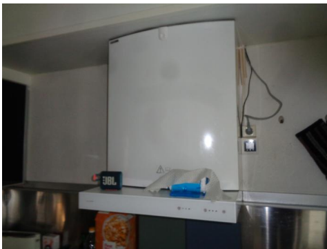
Balansert ventilasjon montert i en utleiedel.
