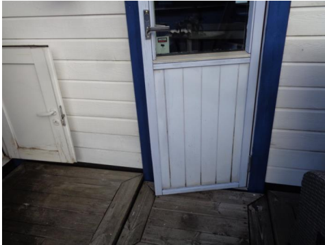
Noe dårlig altandør til takterrasse.
