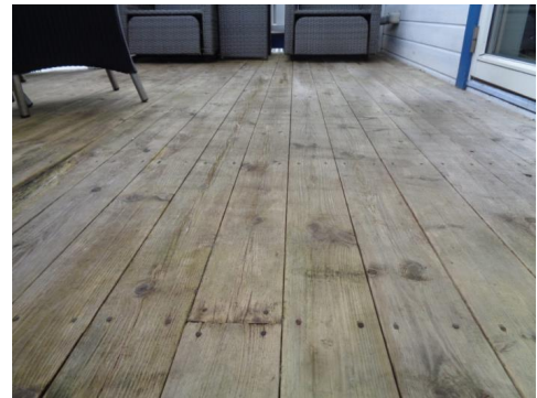
Lite åpning mellom terrassebord. Noe oppsprekk i bord.
