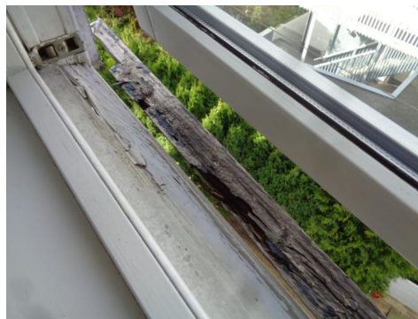
Løs og råteskade på regnbord. Vindu må kanskje skiftes.
