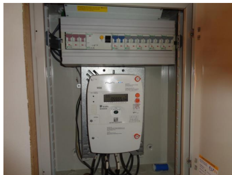
Sikringskap i utleiedel.
