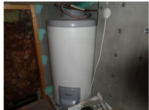
Varmtvannsbereder på loft.
