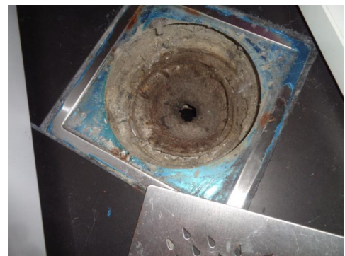
Sluk på vaskerom.
