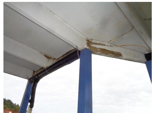
Malingsavskalling som tyder på fukt mellom altanene.
