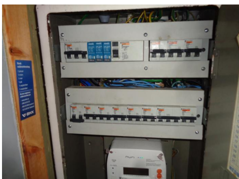
Sikringskap i 2. etasje.
