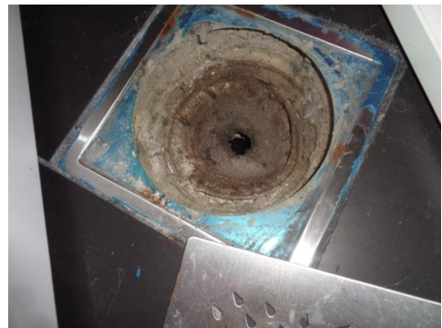
Sluk på vaskerom.
