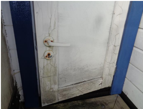
Dårlig dør til knevegg på takterasse.
