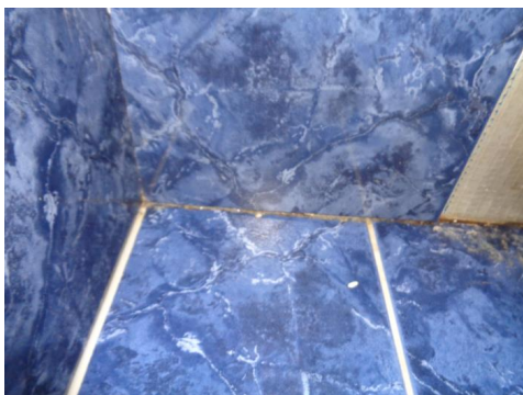
Dårlige fuger i dusjsone.
