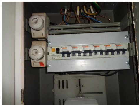
Sikringskap i utleiedel.
