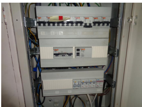
Sikringskap i 2. etasje.
