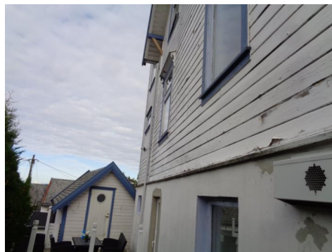
Maling slitt kledning.
