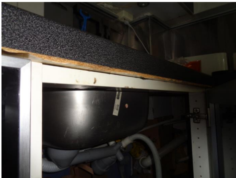
Ødelagt benkeplater på underside ved vask.
