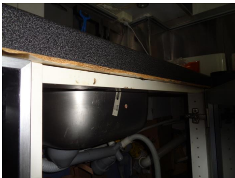
Ødelagt benkeplater på underside ved vask.
