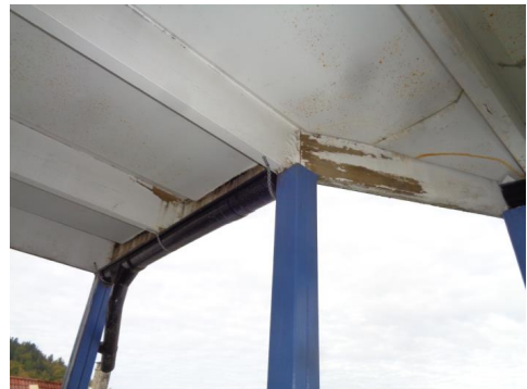
Malingsavskalling som tyder på fukt mellom altanene.
