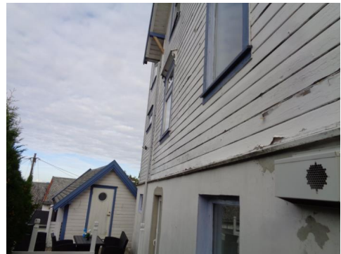
Maling slitt kledning.
