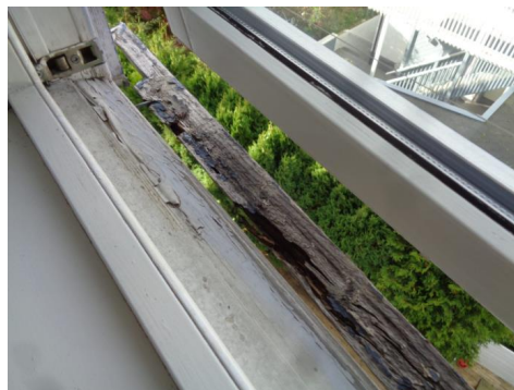
Løs og råteskade på regnbord. Vindu må kanskje skiftes.
