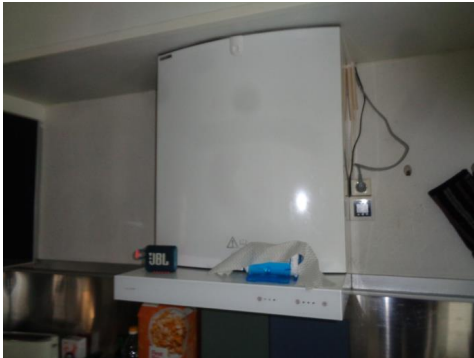
Balansert ventilasjon montert i en utleiedel.
