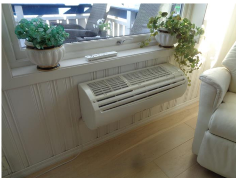
Varmepumpe i stue 2. etasje-
