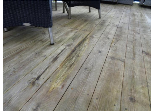
Råteskade på terrassebord.
