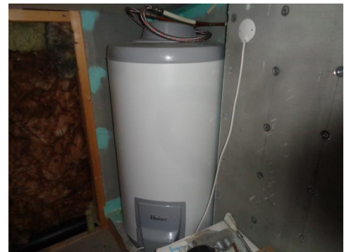
Varmtvannsbereder på loft.
