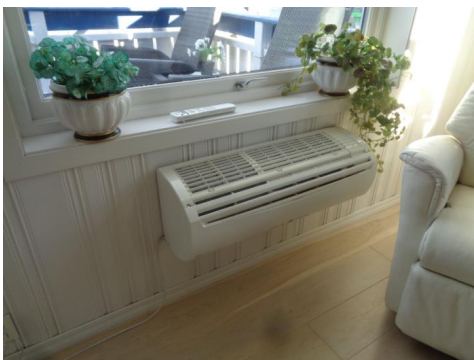
Varmepumpe i stue 2. etasje-
