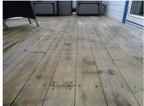
Lite åpning mellom terreassebord. Noe oppsprekk i bord.
