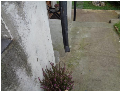
Nedløp ikke ført til bakke.
