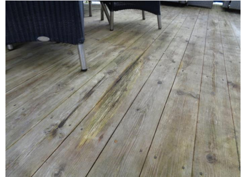
Råteskade på terrassebord.
