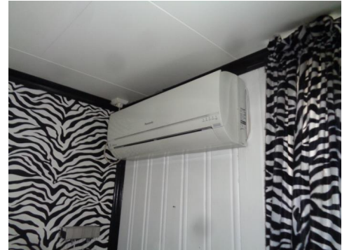
Varmepumpe i kontor 1. etasje.
