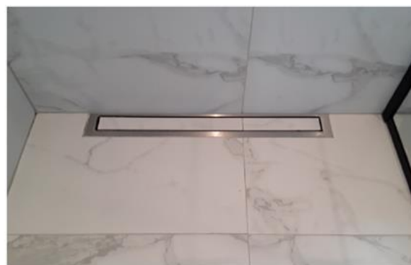
Våtrom - [Sluk - Bad 1. etasje]
