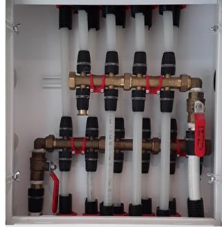
Tekniske anlegg, VVS anlegg (Sjekkpunkter utover det som er inkludert i andre rom) - [Fordelerskap til rør-i-rør system - Bad 1. etasje]
