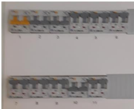
Elektrisk anlegg - [Sikkeringskap Underetasje]
