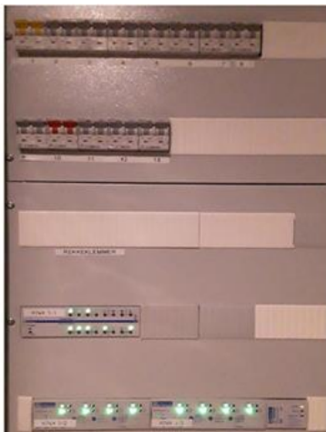
Elektrisk anlegg - [Sikkeringskap 1. etasje]
