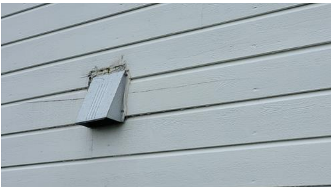
Utvendig - [Skade i utvendig kledning.]
