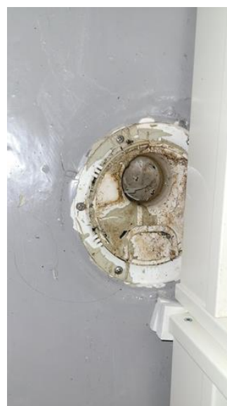
Våtrom - [Sluk vaskerom.]
