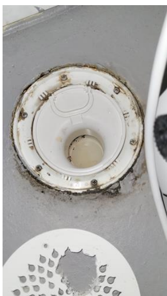
Våtrom - [Sluk vaskerom.]
