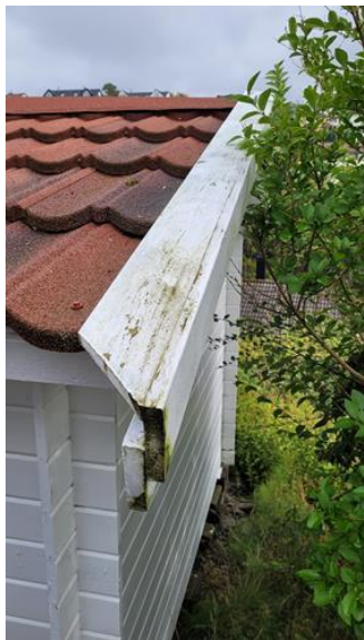
Utvendig - [Slitasjepreg på overflater.]
