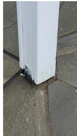
Utvendig - [Lav overdekning søyle.]
