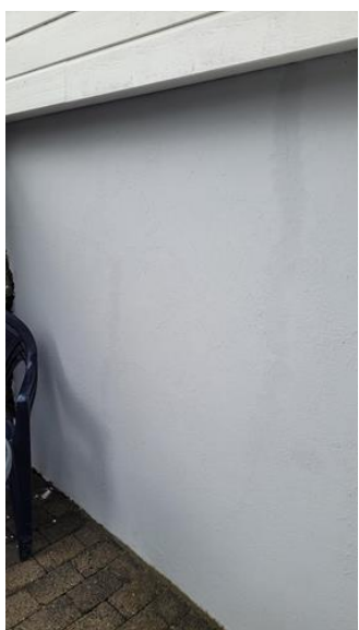
Utvendig - [Riss i grunnmur.]
