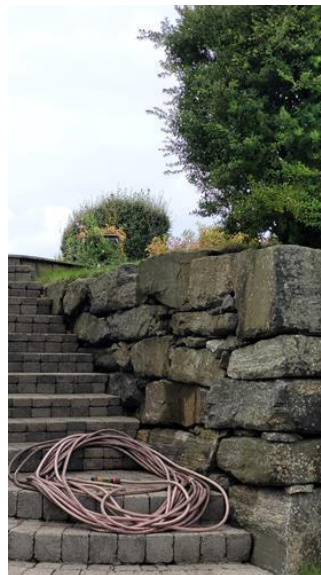
Utvendig - [Trapp/mur mangler rekkverk.]
