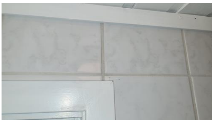
Våtrom - [Riss i flisefuger.]
