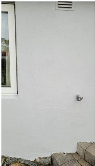
Utvendig - [Riss i grunnmur.]
