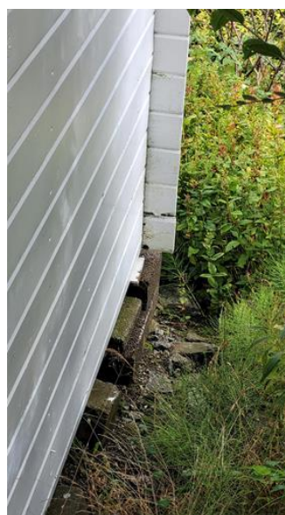
Utvendig - [Råteskade, gjelder frittstående bod.]
