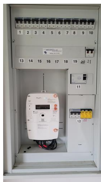
Elektrisk anlegg - [Sikringsskap.]
