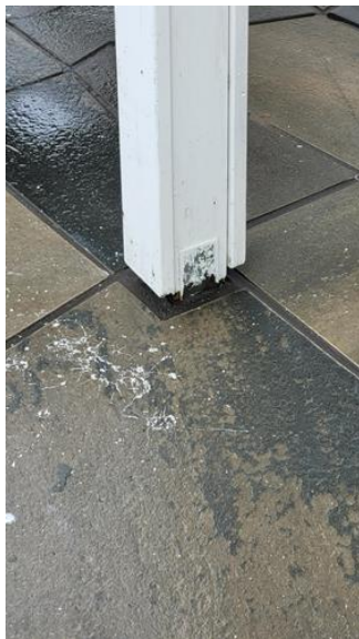
Utvendig - [Lav overdekning søyle.]
