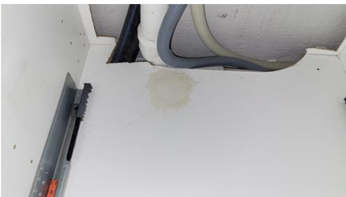
Kjøkken - [Drypplekasje i benkeskap.]
