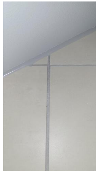
Våtrom - [Riss i flisefug over dør.]
