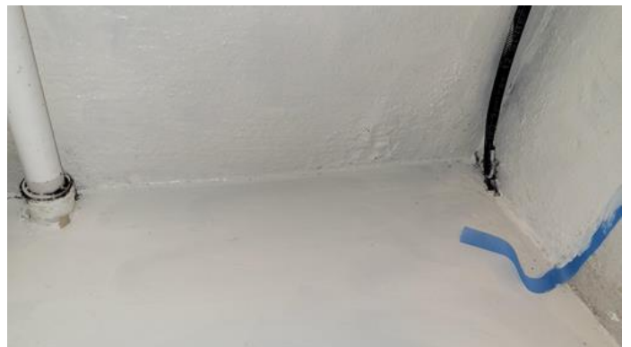
Våtrom - [Saltutslag på vegg.]
