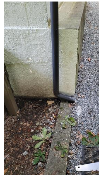
Utvendig - [Nedløp fra takvann avsluttet over bakkenivå.]
