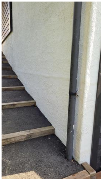
Utvendig - [Sprekke i yttervegg.]
