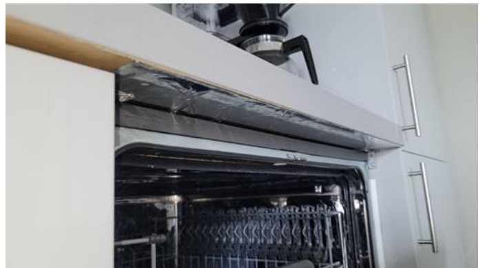
Kjøkken - [Svelleskade benkeplate.]
