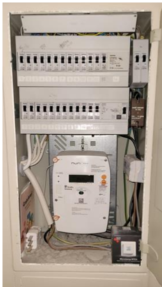
Elektrisk anlegg - [Sikringsskap (hovedenhet).]
