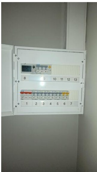
Elektrisk anlegg - [Sikringsskap (leilighet).]
