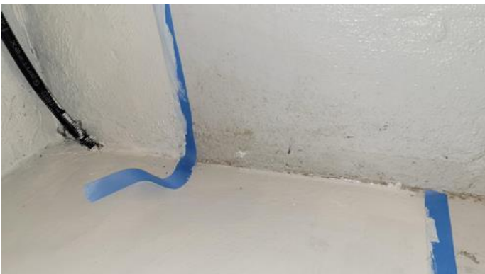
Våtrom - [Saltutslag på vegg.]
