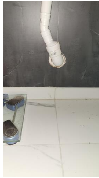
Våtrom - [Sluk under vask.]
