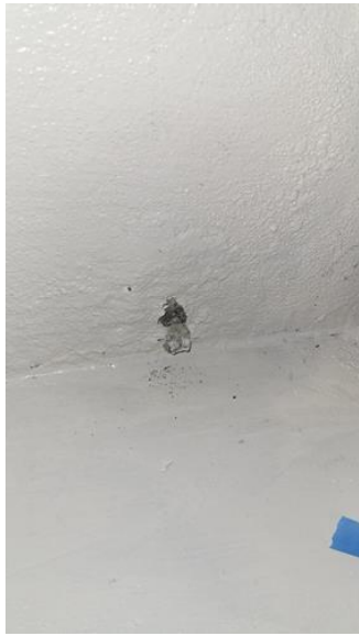
Våtrom - [Saltutslag på vegg.]
