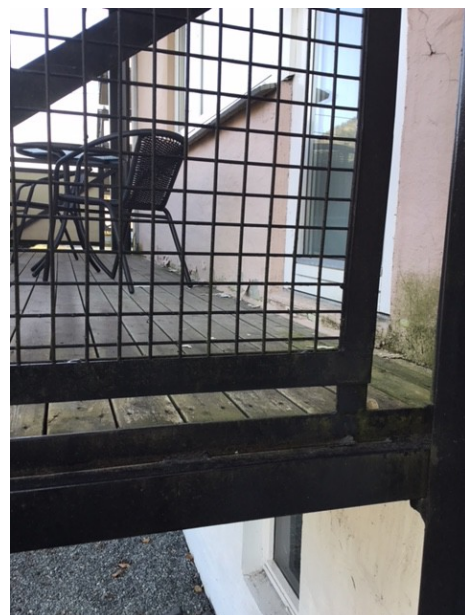
Fukt i bunn fasade mot balkonggulv
