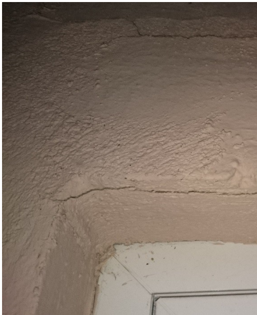
Sprekk over stuevindu
