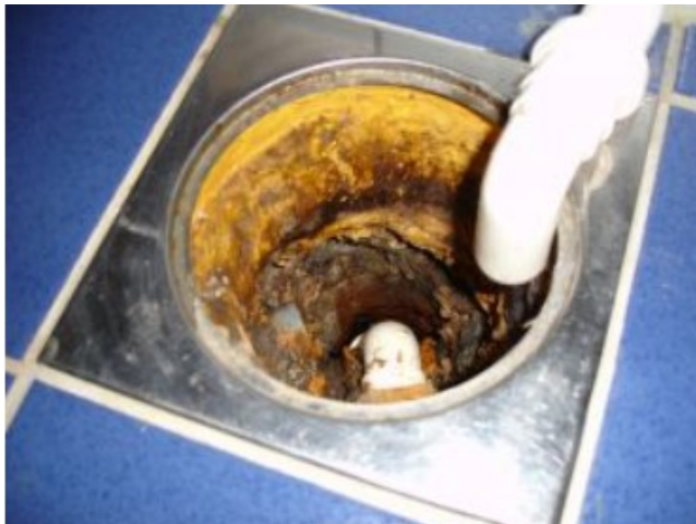
Figur 1 Typisk eksempel på utdatert sluk i baderom, uten klemring mellom sluk og gulvbelegg.
