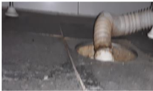
Våtrom - [Sluk under dusjkabinett - Bad]
