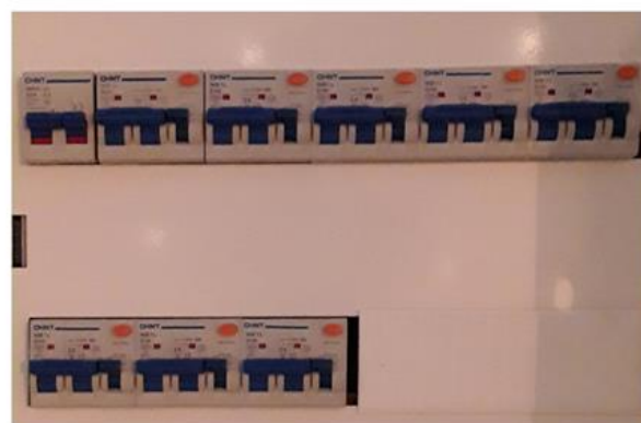
Elektrisk anlegg - [Sikringskap]
