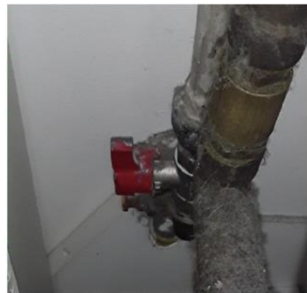
Tekniske anlegg, VVS anlegg (Sjekkpunkter utover det som er inkludert i andre rom) - [Vanninntaksrør og stoppekran - Vaskerom]
