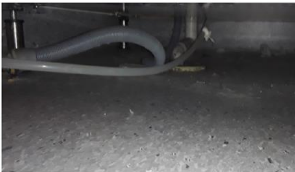
Våtrom - [Sluk under innredning - Vaskerom]
