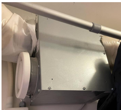
Avtrekksmotor på bod.
