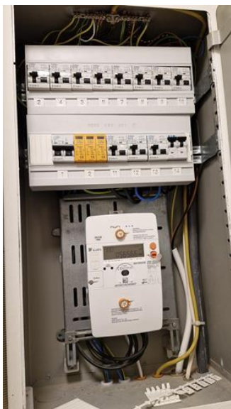
Elektrisk anlegg - [Sikringsskap]
