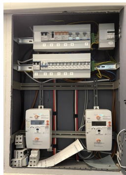
Felles sikringskap i felles trappegang
