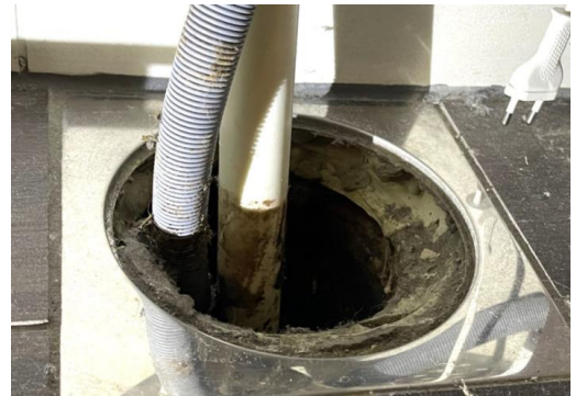
Sluk under baderomsinnredning
