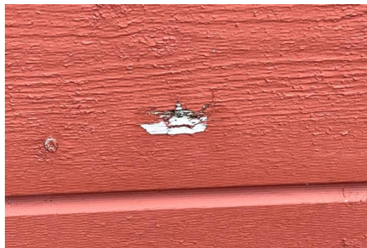
Sår i treverk
