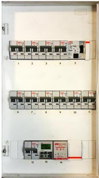
Elektrisk anlegg - [Sikringskap]
