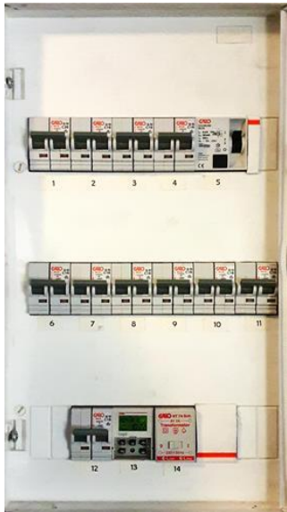
Elektrisk anlegg - [Sikringskap]
