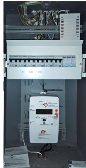
Elektrisk anlegg - [Sikringsskap]
