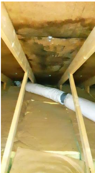
Loft - uinnredet / råloft - [Fuktmerker undertak, tørre på befaringssdag.]
