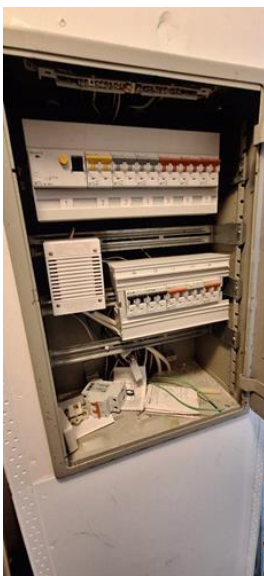
Elektrisk anlegg - [Sikringskap.]
