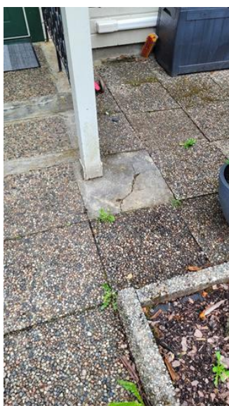
Utvendig - [Søyle har liten avstand til terrenget. Forholdet kan føre til forkortet levet]
