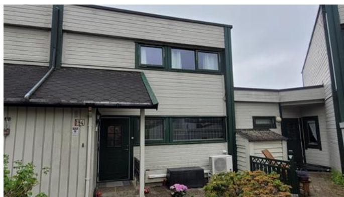
Utvendig - [Fasade bærer preg av slitasje.]
