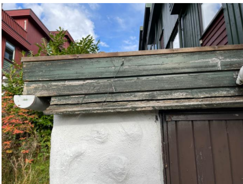
Sprukket og råteskadet treverk på gammel utebod
