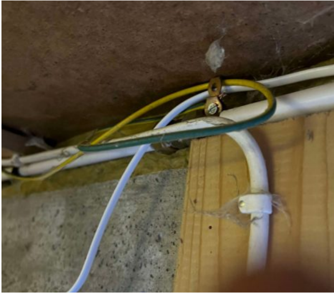
Bilde 1 Jording til stikkontakt er tilkoblet vannrør/kobber på innside bod.
