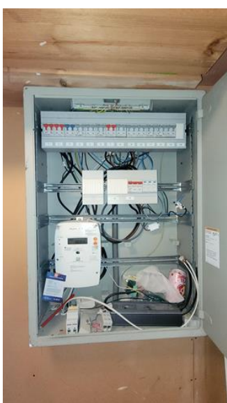
Elektrisk anlegg - [Sikringsskap.]
