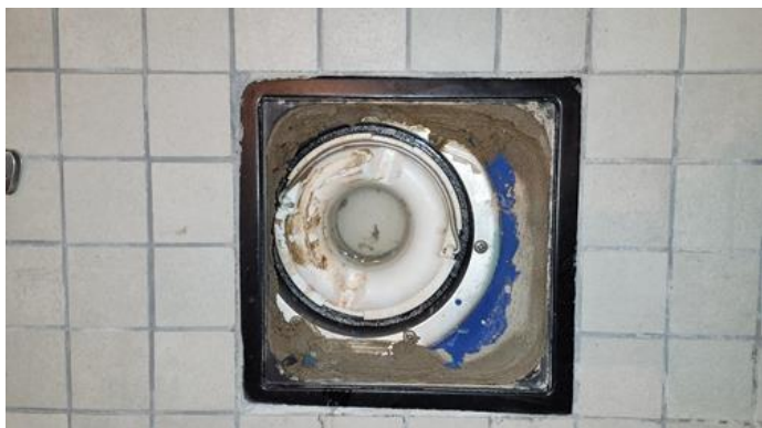
Våtrom - [Sluk bad underetasje 1.]
