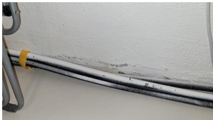
Våtrom - [Avleiring av salt/kalkutslag på grunnmur/gulv mot grunn.]
