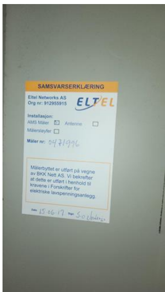
Elektrisk anlegg - [Samsvarserklæring AMS-måler.]
