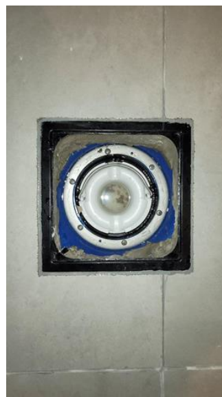
Våtrom - [Sluk bad underetasje 2.]
