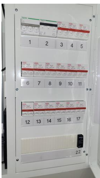
Elektrisk anlegg - [Sikringskap.]
