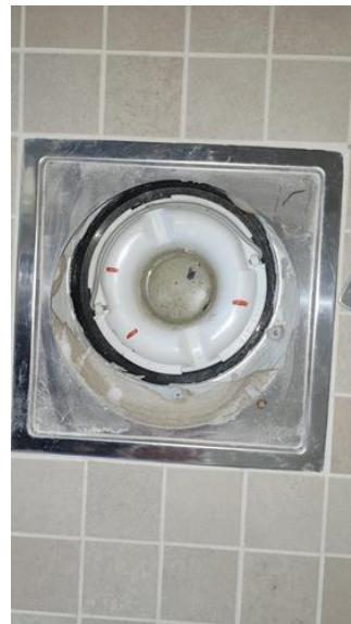
Våtrom - [Sluk bad loftsetasje.]
