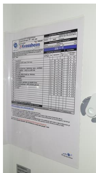
Elektrisk anlegg - [Kursfortegnelse.]
