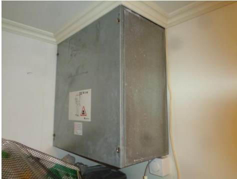
Balansert ventilasjonsanlegg på vaskerom.
