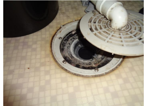
Plastsluk på vaskerom.
