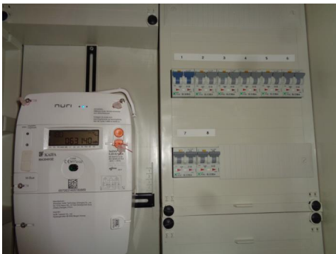
Sikringskap i entrè.
