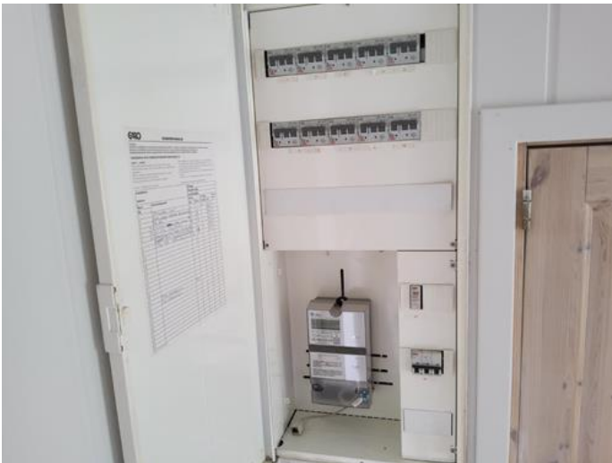
Elektrisk anlegg - [Sikringskap ]
