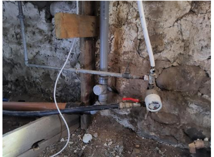
Tekniske anlegg, VVS anlegg (Sjekkpunkter utover det som er inkludert i andre rom) - [Stoppekran og vanmåler ]
