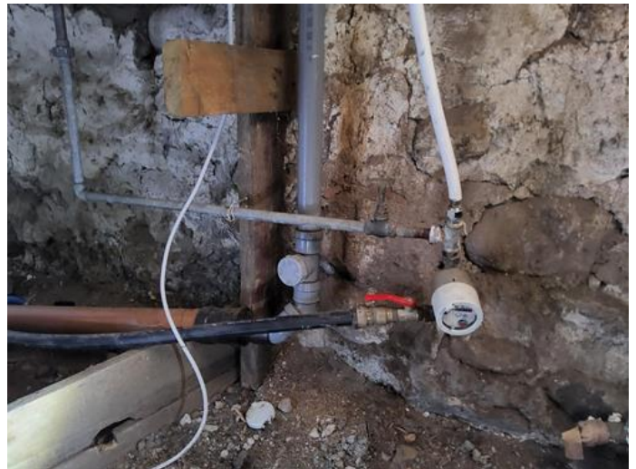
Tekniske anlegg, VVS anlegg (Sjekkpunkter utover det som er inkludert i andre rom) - [Stoppekran og vanntmåler ]
