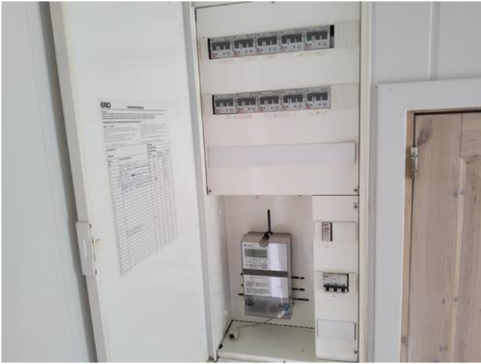
Elektrisk anlegg - [Sikringskap ]
