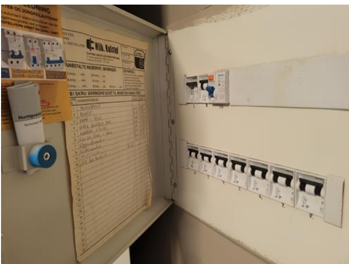
Elektrisk anlegg - [Sikringskap med kursfortegnelse er
