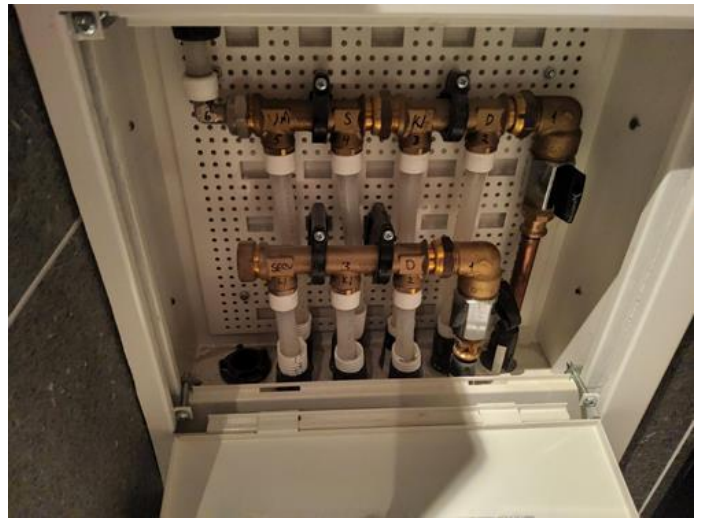
Tekniske anlegg, VVS anlegg (Sjekkpunkter utover det som er inkludert i andre rom) - [Fordelingskap for rør-i-rør plassert på bad.]
