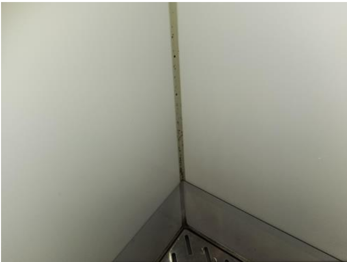
Kommentar - [svertesopp på fug i dusjsonen]
