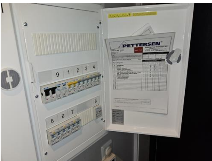
Elektrisk anlegg - [sikringskap]
