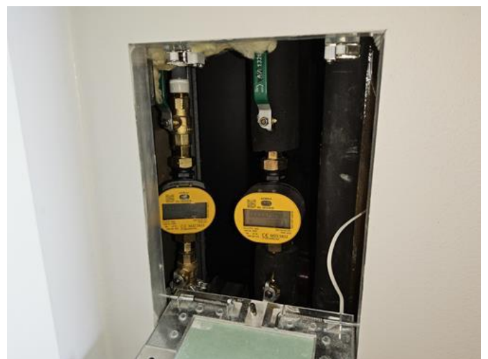
Hovedstoppekran - [Hovedstoppekran, plassert i luke ved kjøkkenet.]
