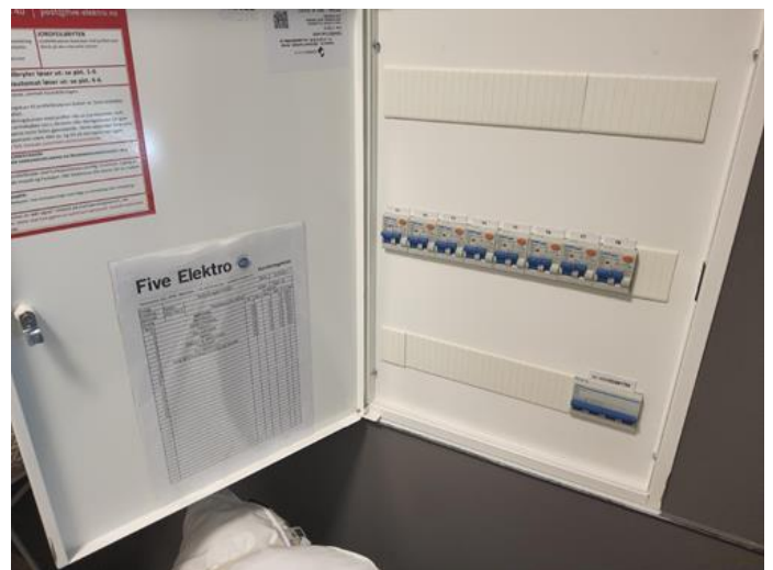
Elektrisk anlegg - [Sikringsskap med kursfortegnelse plassert i bod.]
