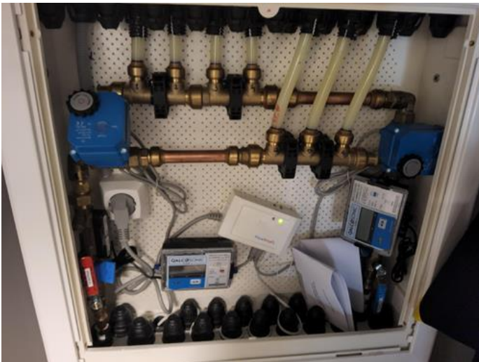
Tekniske anlegg, VVS anlegg (Sjekkpunkter utover det som er inkludert i andre rom) - [Fordelerskap for rær-i-rør med stoppekraner og vannstopper plassert i bod.]
