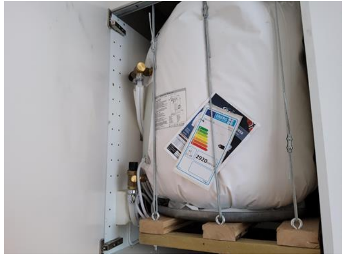
Varmtvannsbereder - [Varmtvannsbereder plassert i kjøkken overskap.]
