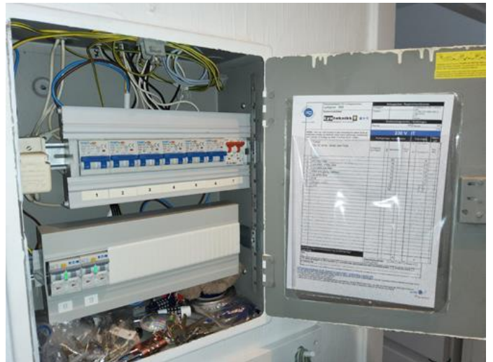
Elektrisk anlegg - [Sikringskap med kursfortegnelse er plassert i entre.]
