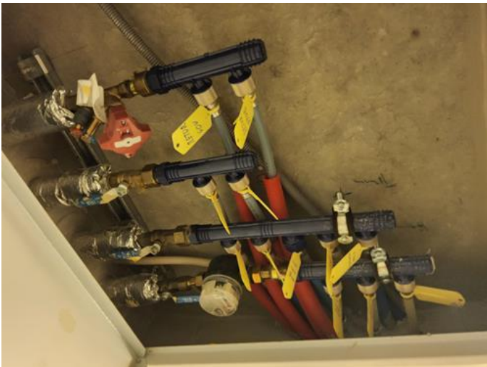
Tekniske anlegg, VVS anlegg (Sjekkpunkter utover det som er inkludert i andre rom) - [Fordelerstokk for rør-i-rør, vannmåler og stoppekran er plassert i luke i tak bad.]
