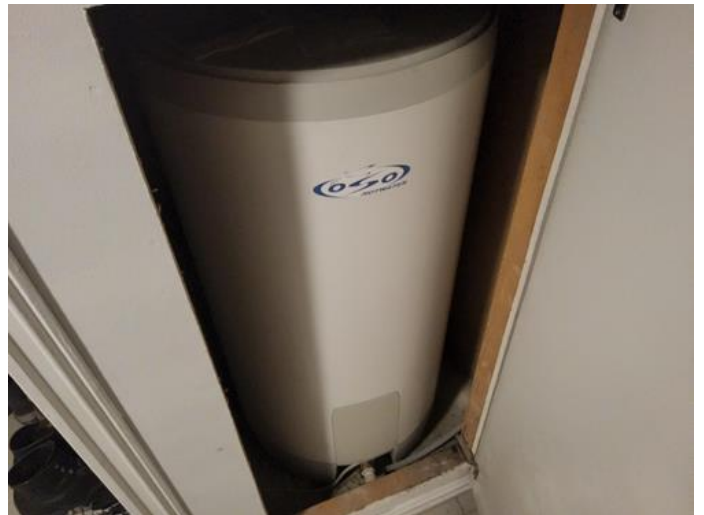
Tekniske anlegg, VVS anlegg (Sjekkpunkter utover det som er inkludert i andre rom) - [Varmtvannsbereeder plassert i trappegang.]
