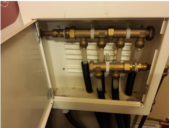
Tekniske anlegg, VVS anlegg (Sjekkpunkter utover det som er inkludert i andre rom) - [Fordelerskap for rør i rør plassert i bod.]
