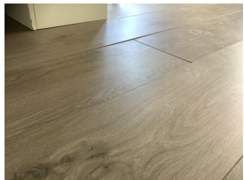
Glipper i langsgående skjøt laminatgulv ved pipe.
