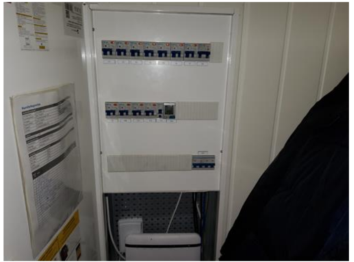
Elektrisk anlegg - [Sikringskap. ]
