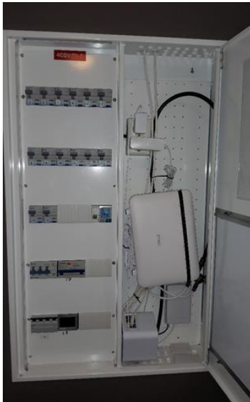
Elektrisk anlegg - [Sikringsskap ]
