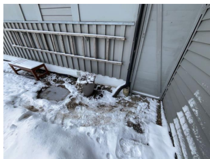
Taknedløpet må ledes vekk fra grunnmur. Det må lages en bedre dreneringsløsning her.
