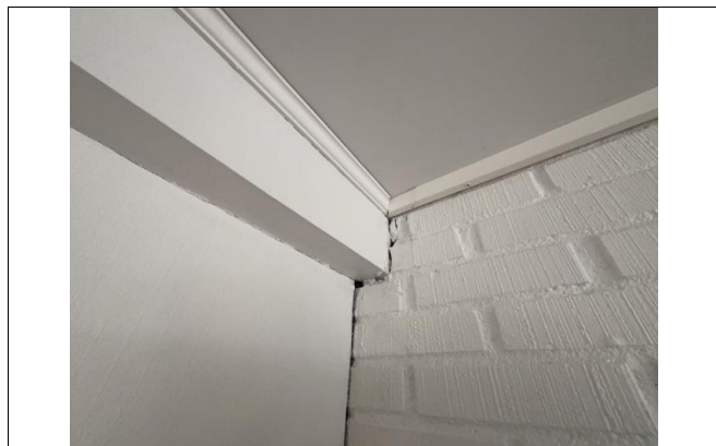
Glipper i overgang vegg- og takflate.
