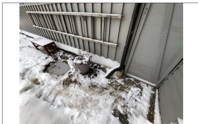
Iflg. eier: Vanninnsig her til kjeller ved sterk nedbør i feb. 2024.
