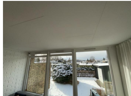
Luftespalter i vinduer.
