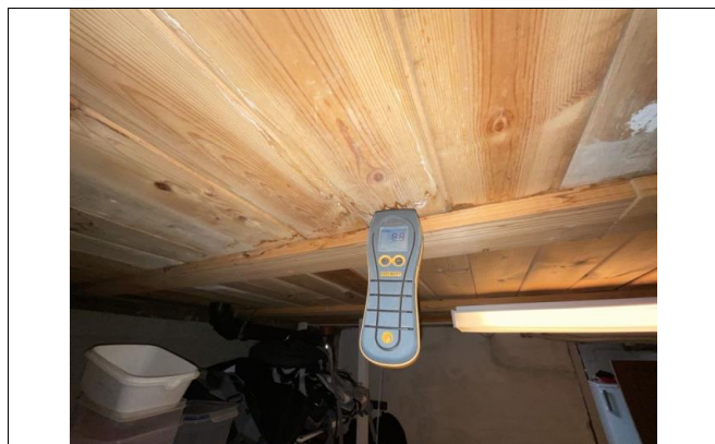
Fuktskjold i kjellertak under baderommet. Protimeter fuktapparat gjorde ikke utslag ved fuktsøk med piggelektrode i treverket.
