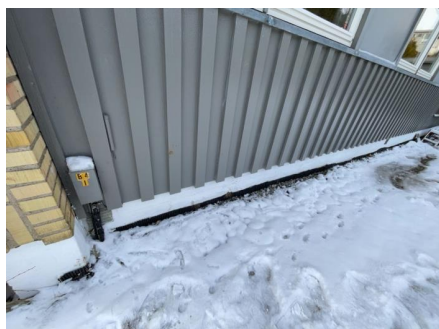
Synlig grunnmurspapp, mangler topplast.
