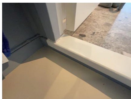
Luftespalte under dørbladet.
