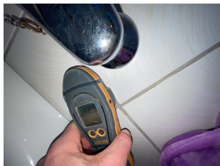
Fuktsøk med Protimeter fuktapparat ga ikke utslag her.
