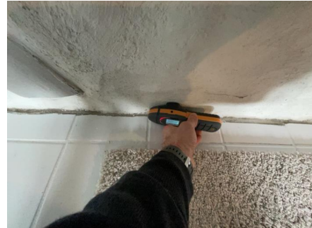
Fuktutslag med Protimeter fuktapparat.
