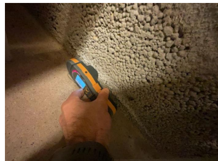
Fuktutslag med Protimeter fuktapparat.
