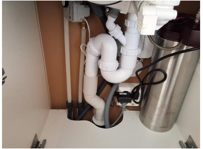
Kjøkkenen - [Røropplegg i kjøkkenbenk]
