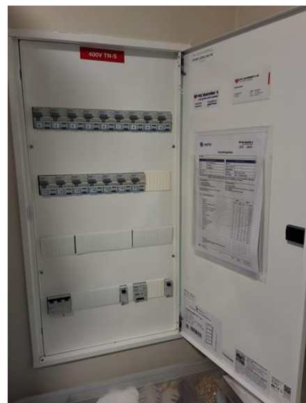
Elektrisk anlegg - [Sikringskap i tekniskrom]
