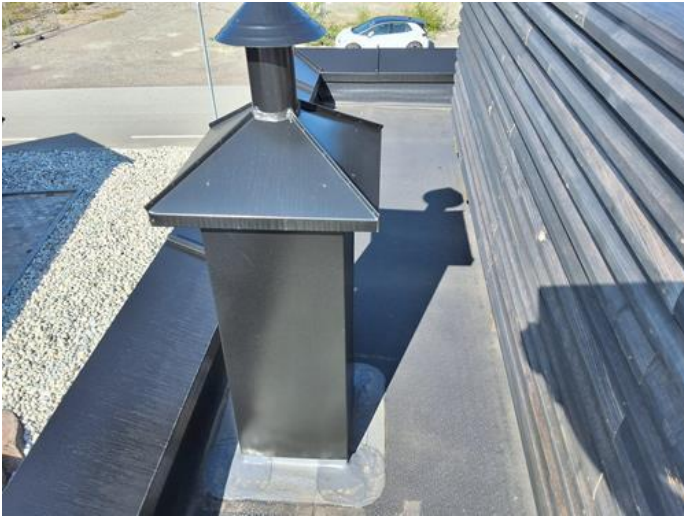
Utvendig - [Luftehatt over tak]
