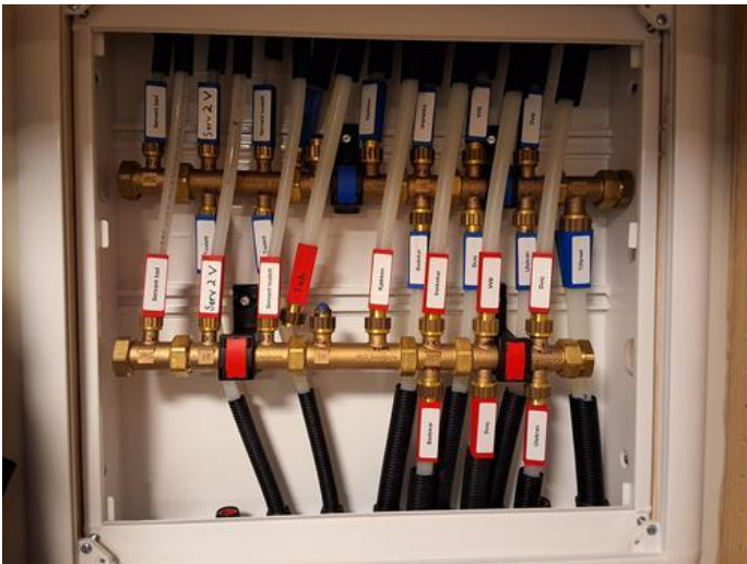
Tekniske anlegg, VVS anlegg (Sjekkpunkter utover det som er inkludert i andre rom) - [Fordelerskap for vannrør]
