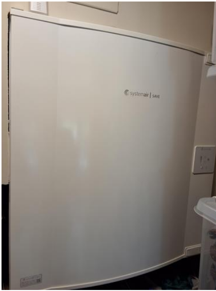
Tekniske anlegg, VVS anlegg (Sjekkpunkter utover det som er inkludert i andre rom) - [Ventilasjonsanlegg i tekniskrom]
