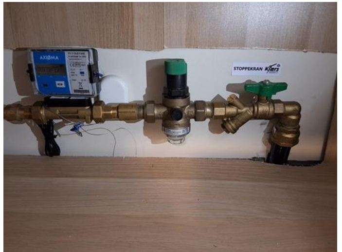
Tekniske anlegg, VVS anlegg (Sjekkpunkter utover det som er inkludert i andre rom) - [Stoppekran og vannmåler på vaskerom]
