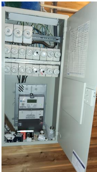
Elektrisk anlegg - [Sikringskap]
