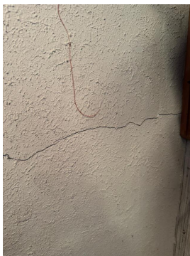
Innvendig horisontalt riss/sprekk
