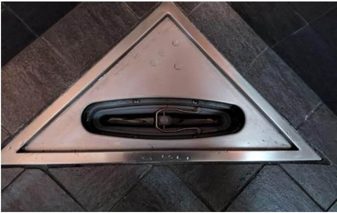
Avløpsrør (ink. sluk) - [Sluk på bad 1.etasje ]
