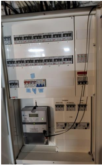
Elektrisk anlegg - [Sikringsskap ]
