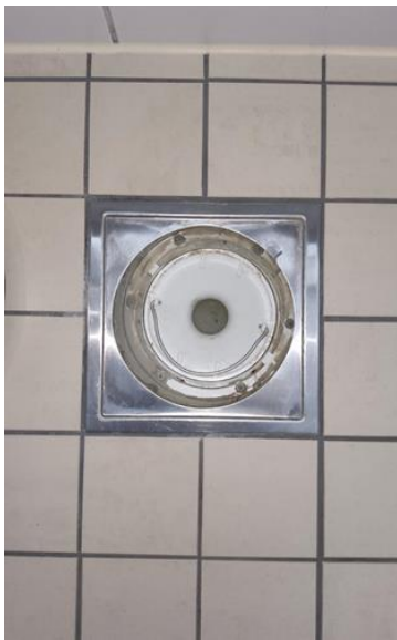
Avløpsrør (ink. sluk) - [Hovedsluk på bad 2.etasje ]
