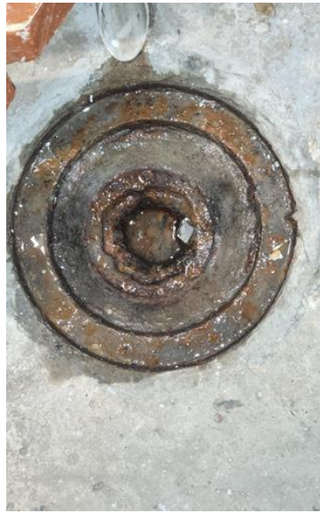
Avløpsrør (ink. sluk) - [Sluk på vaskerom ]
