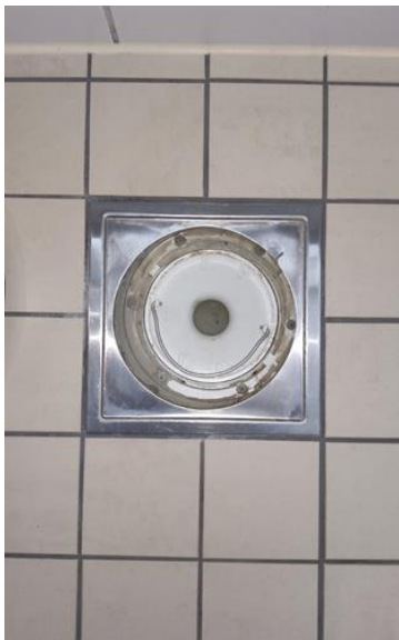
Avløpsrør (ink. sluk) - [Hovedsluk på bad 2.etasje ]
