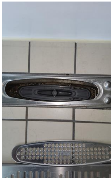
Avløpsrør (ink. sluk) - [Sluk i dusj på bad 2.etasje ]
