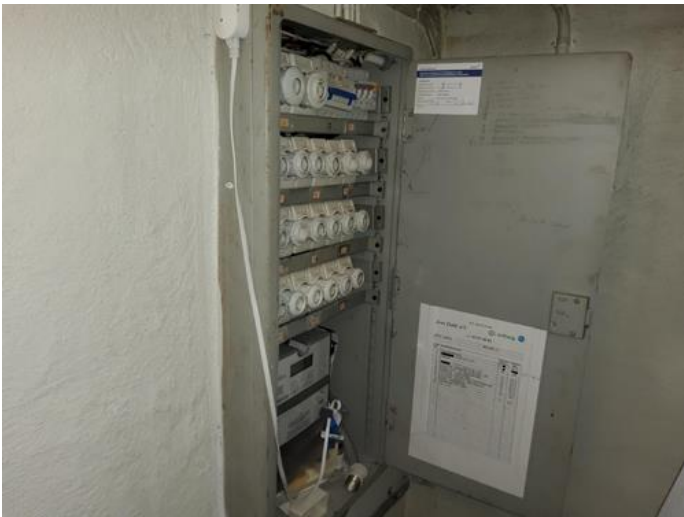
Elektrisk anlegg - [Sikringskap.]
