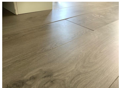
Glipper i langsgående skjøt laminatgulv ved pipe.
