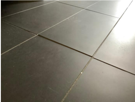
Høydeforskjell/sprang mellom fliser i gang.
