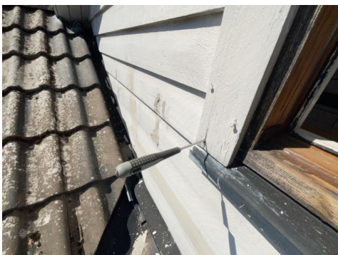
Råte i omrammingsbord mot vannbrett
