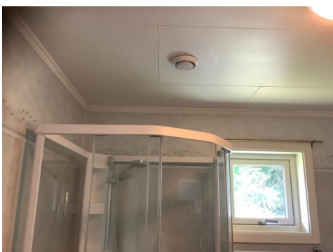
Ventilasjon i himling på bad.
