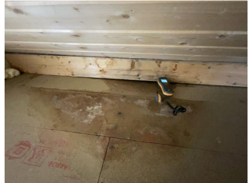
Skjolde kneloft målt tørt befaringsdagen.
