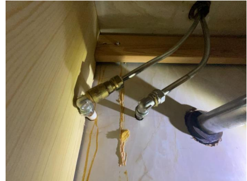
Ikke spesielle tetninger rundt rør (området rundt servant til gulv er våtzone)
