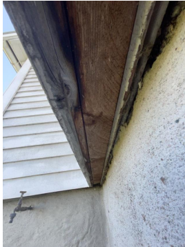
Ulufte panel- kan se ut å være utenfor en tidl. panel.
