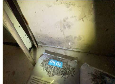
Gipsplater er noe skjoldete/fuktbelastet
