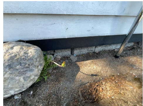
Oppusset lav mur
