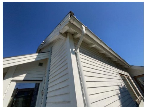
Ingen ventilering av takkonstruksjonen kan synes.
