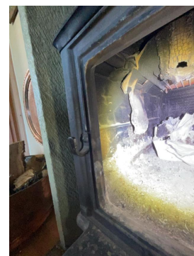
Skadede brannplater inv. i vedovn
