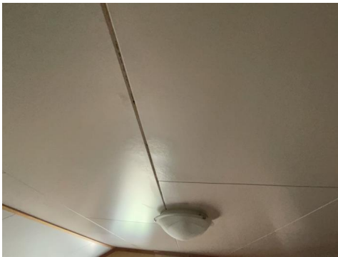
Svelling takess etter tidl. lekkasje
